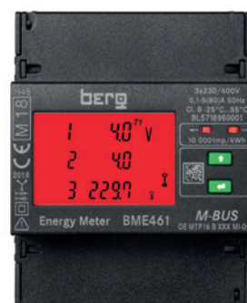
Installationsfehler erkennbar durch Farbumschlag im Display
